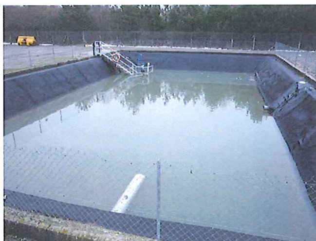
Lagune eaux industrielles 1
