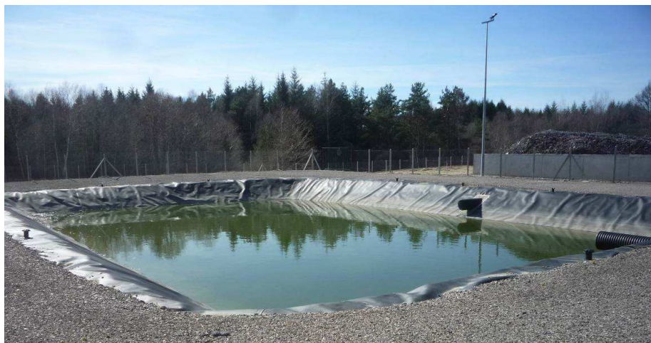
Lagune eaux industrielles 3
